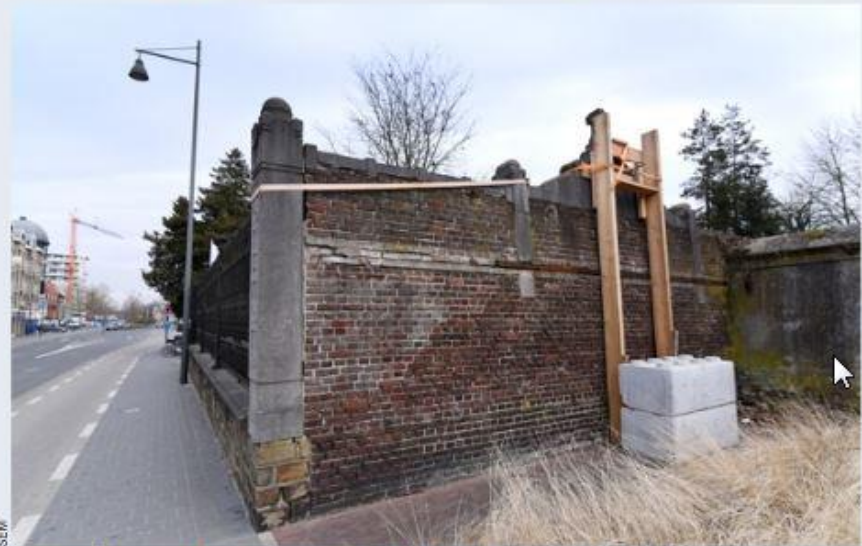
■ De muur is beschadigd en wordt met balken en betonblokken gestut.
